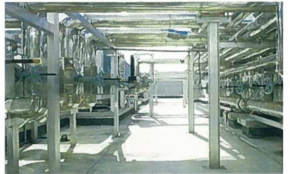
元ホテルシティコート那覇(屋上配管状況)
