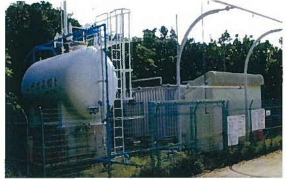
読谷リゾートLPガス供給施設
