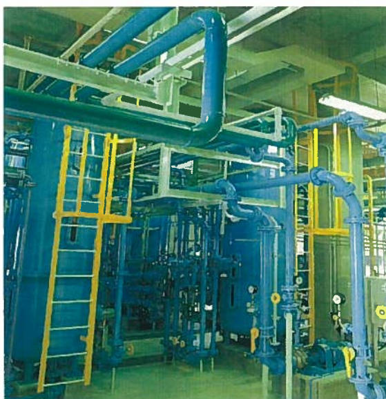
石川石炭火力発電所(純水製造装置)
