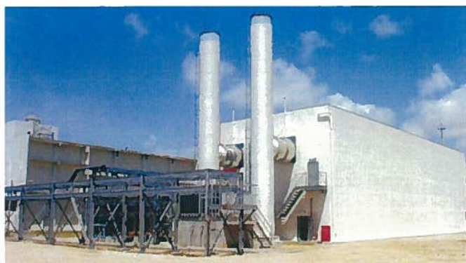
石垣第二発電所 ガスタービン(平成12年)
