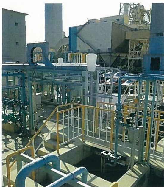
石川石炭火力発電所(回収水処理装置)
