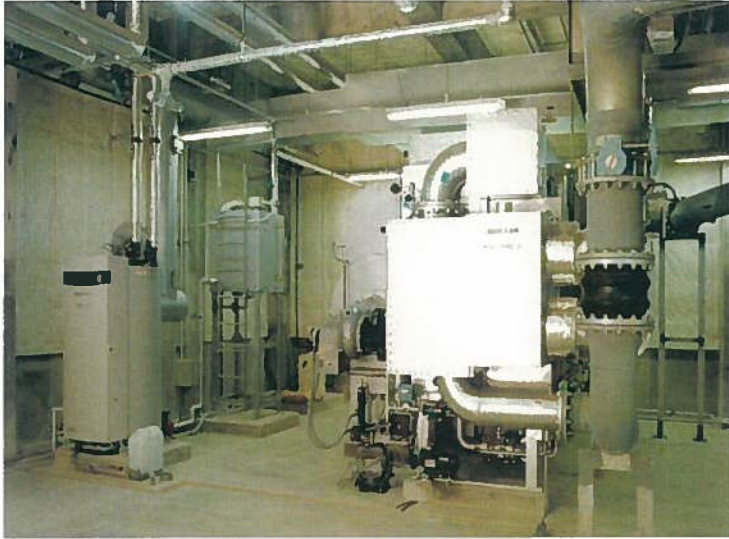
ザ・ブセナテラス機械室(平成9年)
